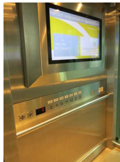
Hauptaufzüge vom atrium zu den verschiedenen Ebenen
