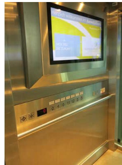
Hauptaufzüge vom atrium zu den verschiedenen Ebenen
