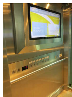
Hauptaufzüge vom atrium zu den verschiedenen Ebenen
