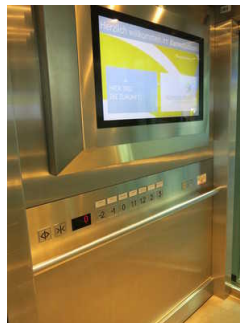
Hauptaufzüge vom atrium zu den verschiedenen Ebenen
