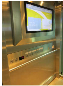
Hauptaufzüge vom atrium zu den verschiedenen Ebenen
