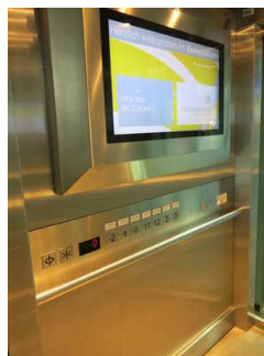
Hauptaufzüge vom atrium zu den verschiedenen Ebenen
