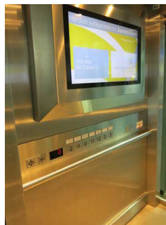
Hauptaufzüge vom atrium zu den verschiedenen Ebenen
