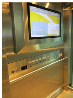
Hauptaufzüge vom atrium zu den verschiedenen Ebenen
