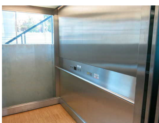
Aufzug zwischen Foyer 1.07 und Foyer 3.12
