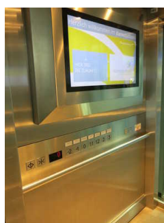
Hauptaufzüge vom atrium zu den verschiedenen Ebenen
