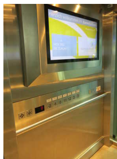
Hauptaufzüge vom atrium zu den verschiedenen Ebenen
