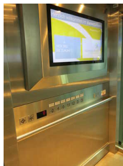
Hauptaufzüge vom atrium zu den verschiedenen Ebenen
