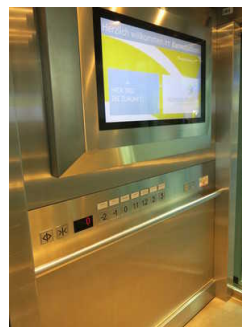
Hauptaufzüge vom atrium zu den verschiedenen Ebenen
