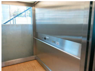
Aufzug zwischen Foyer 1.07 und Foyer 3.12
