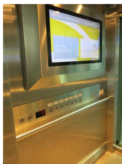
Hauptaufzüge vom atrium zu den verschiedenen Ebenen
