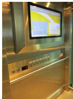
Hauptaufzüge vom atrium zu den verschiedenen Ebenen
