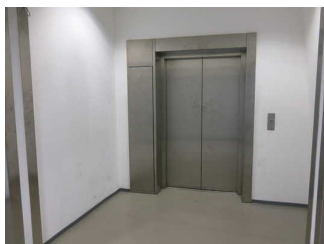
Aufzug zur Dachterasse
