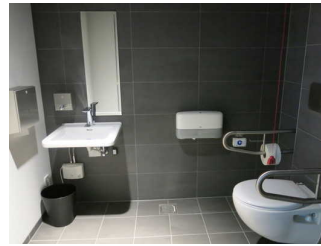
Tür zu WC für Menschen mit Behinderung Raum ferrum
