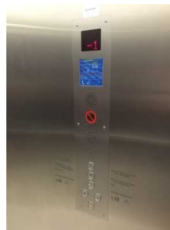
Aufzug von innen
