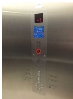
Aufzug von innen
