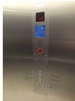
Aufzug von innen
