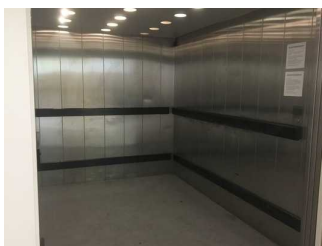
Aufzug vom Vestibül in die Saalebenen
